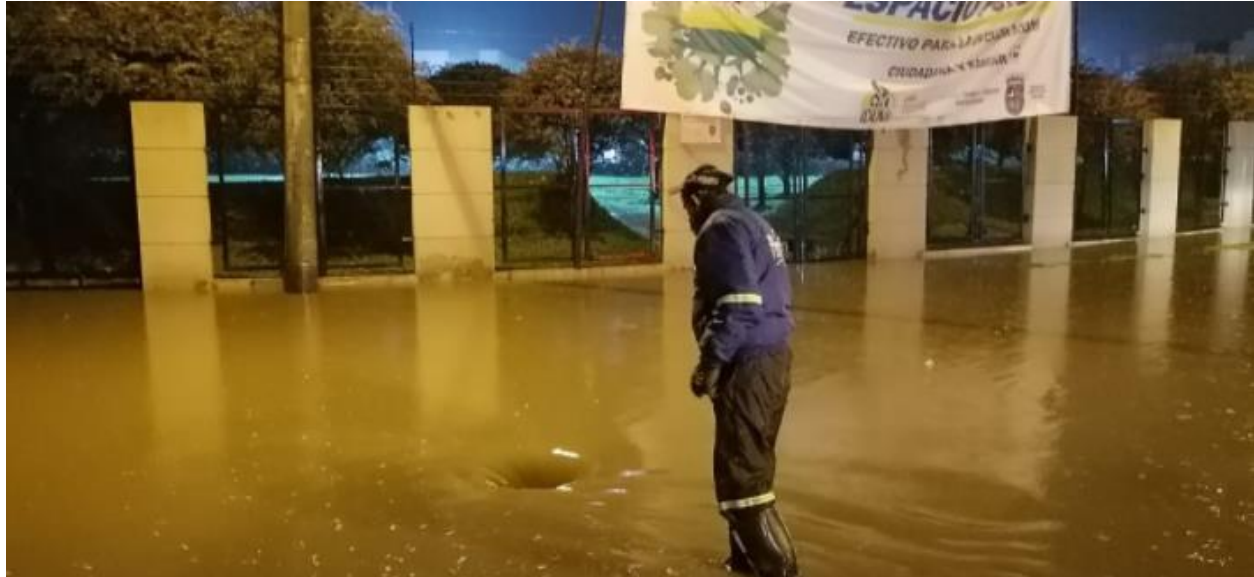
Fotografía 12. Registro histórico de encharcamiento
